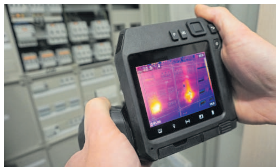
Die Wärmebildkamera zeigt die Temperaturen der Bauteile einer Elektroverteilung.
